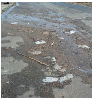
Figura 5 - Resíduo proveniente de escoamento de água de chuva (Observação. Microárea ESF).
