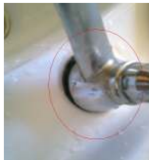
Figura 3 – Vazam. em torneira.
