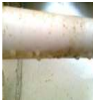
Figura 4 – Tubo de PVC c/ vazamento.
