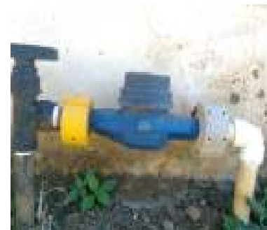
Figura 5 - Hidrômetro mal posicionado.
